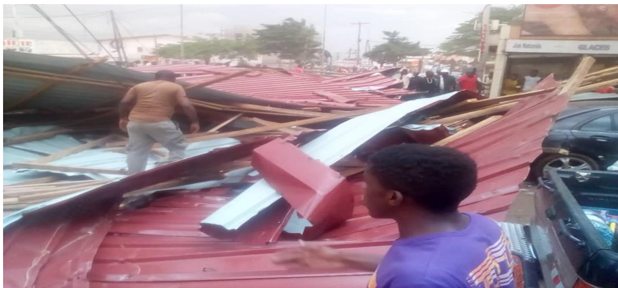
Figure 6 : Toiture de la société Santa Lucia ainsi que des poteaux électriques tombés au quartier Mvan (Yaoundé) due à une forte pluie accompagnée des vents violent le 23 mars 2019.
